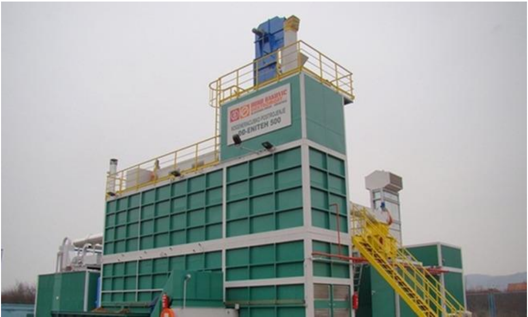
Slika 1. Kogeneracijsko postrojenje na biomasi [4]
