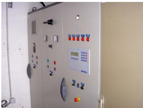
Sl.7 Elektro ormar sa opremom za napajanje sistema i upravljačkom opremom [1]
